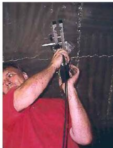
Medición de la profundidad en grietas de una losa dañada por fuego.
